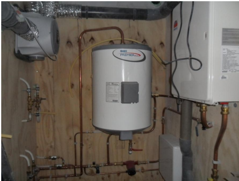
Technische ruimte sanitairruimte camping
